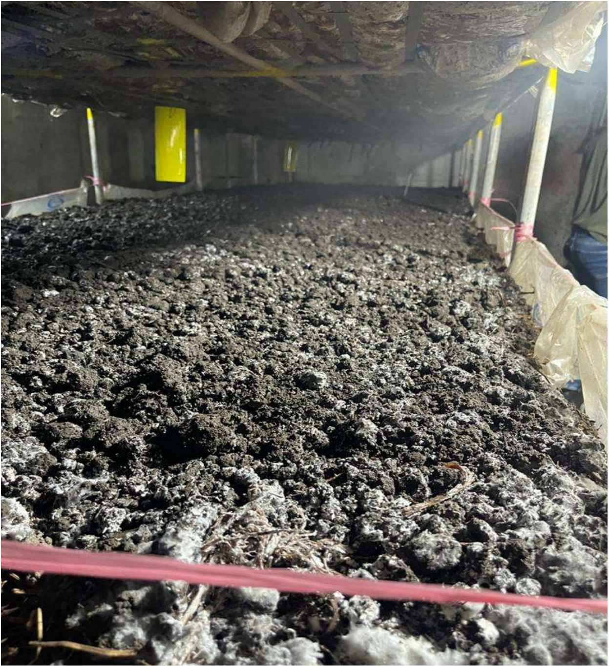
شکل ۱۱ بستر آماده رافلینگ
